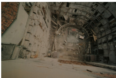
Εικόνα 19. Βενετία, Θέατρο La Fenice, 30 Ιανουαρίου 1996, άποψη μετά την πυρκαγιά © GEOSIGMA SRL Κατασκευαστική Εταιρεία Α.Τ.Ι. Holzmann, μελέτη αρχιτέκτων Aldo Rossi.
